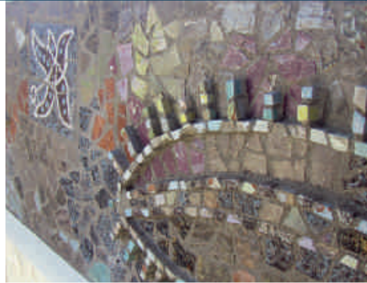
Van dichtbij is de schade aan het mozaïek goed te zien.
